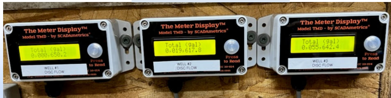
Production meter displays
